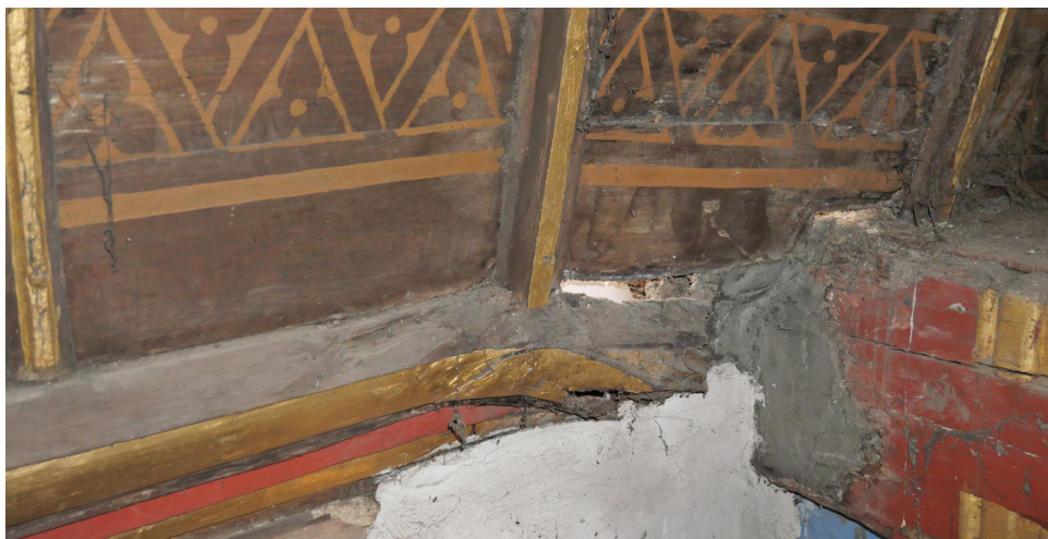
Infiltrations d'eau, plâtre décollé et bois détérioré sous la voûte intérieure.
