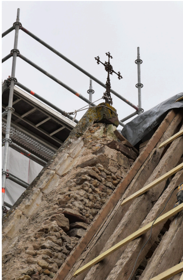
Croix du chevet avant dépose et restauration.
