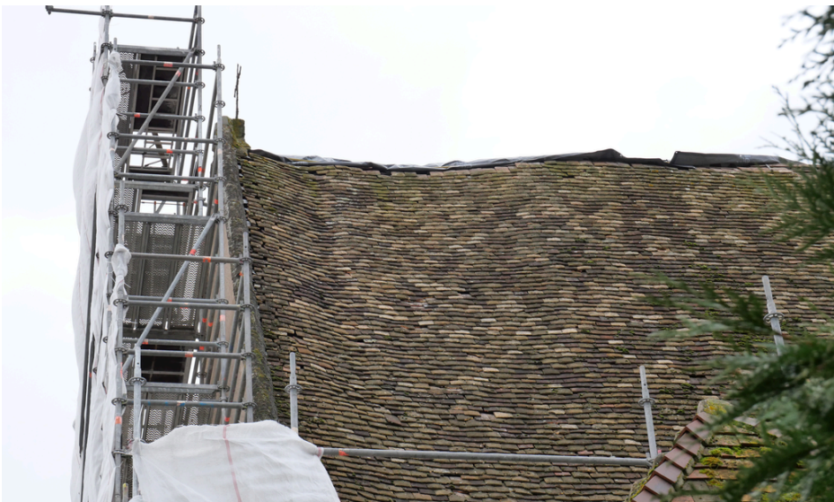
Déformation de la charpente
