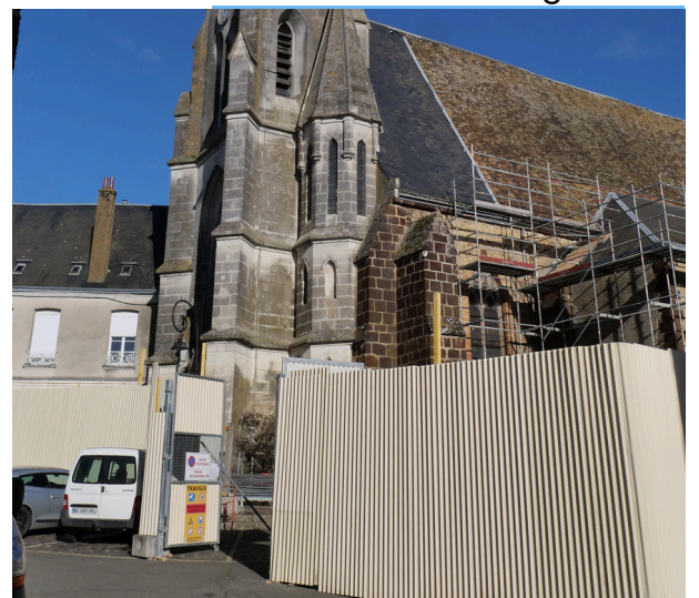
Palissades de protection
